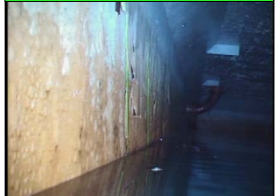
壁面塗装膨れ状況（気中）
