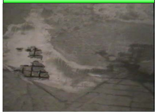
天井部破損状況
