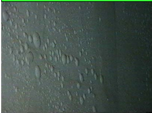
壁面部塗装膨れ状況
